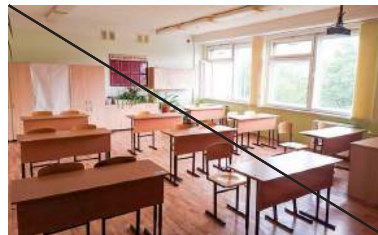
Плохо Линолеум под дерево
